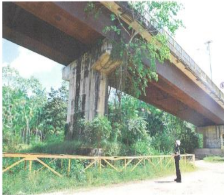
Vegetação do gênero Ficus sobre os consoles dos pilares.
