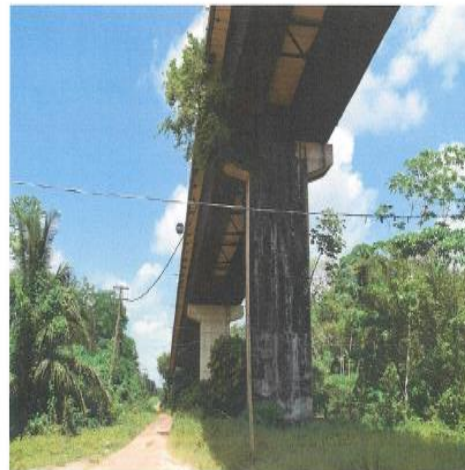
Vegetação do gênero Ficus sobre os consoles dos pilares.
