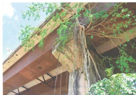
Vegetação do gênero Ficus sobre os consoles dos pilares.
