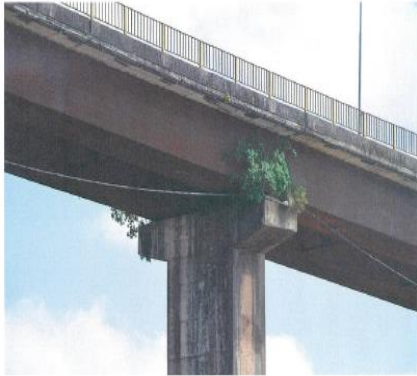
Vegetação do gênero Ficus sobre os consoles dos pilares.
