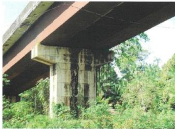
Figura 13 - Manifestação patológica no elemento pilar imediatamente abaixo do sistema de juntas de dilatação. Fonte CBMPA/CEDEC.
