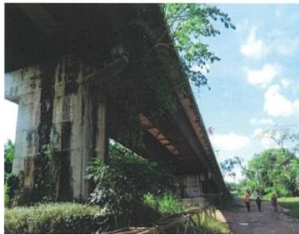
Figura 14 - Estado de conservação de um dos pilares sob a junta de dilatação. Fonte CBMPA/CEDEC.
