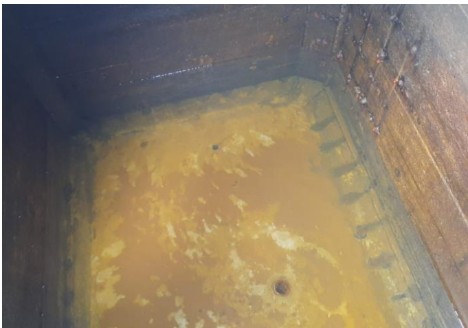
Figura 6 - Cisterna antes da limpeza periódica
